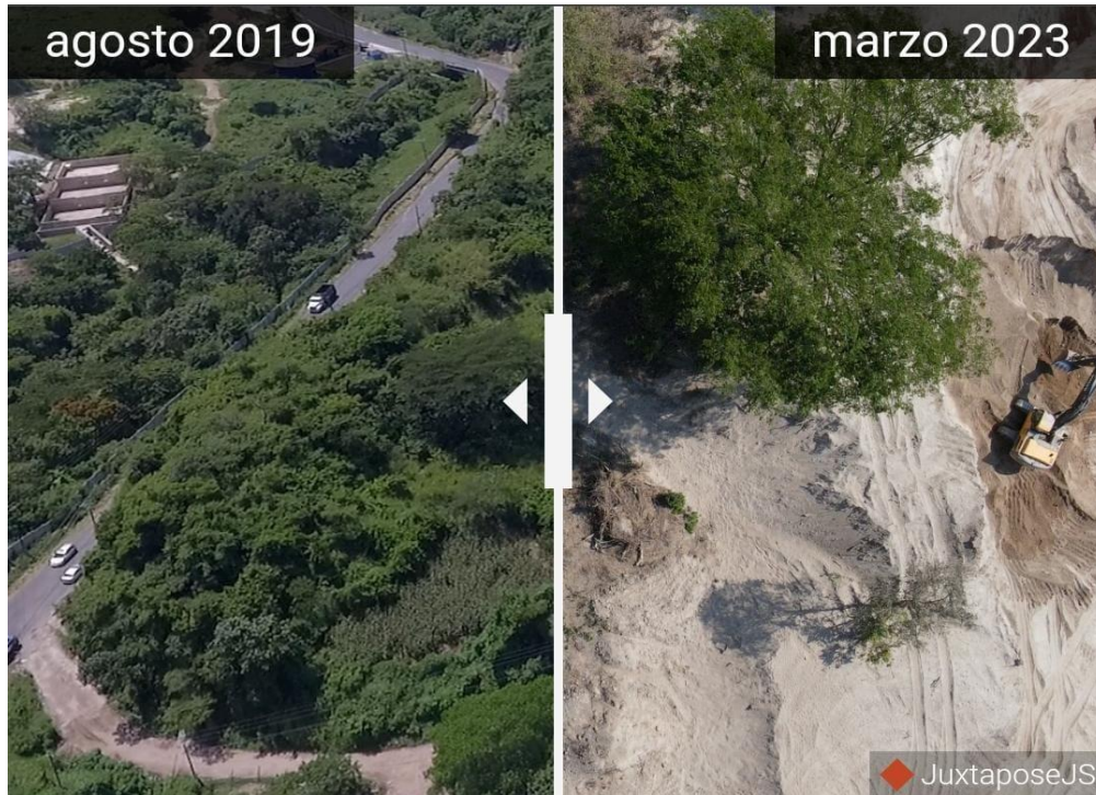
Photo Credits: After Empresa MECO S.A en septiembre de 2022, empezó trabajos de terracería en el cual desbasto y debilito el terreno que sirve como barrera para proteger partes del nacimiento del Río Chacalapa.
