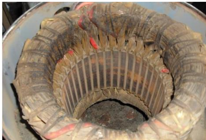
Figura 3.19. Fotografía del proceso donde se observa bobinado que ha sufrido exceso de temperatura. 45
