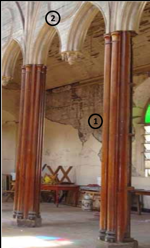
FIG.531 Fotografía interior de la iglesia, donde se observan los elementos estructurales que la conforman.
