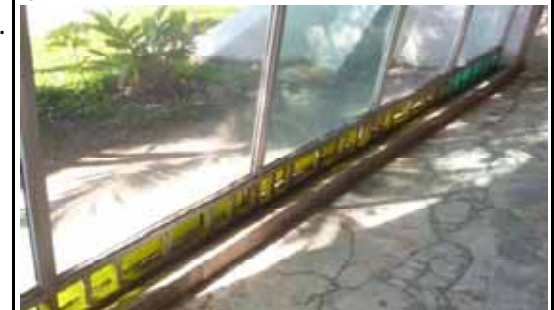
FIG.683 Fotografía de ventanas de vidrio fijo.
