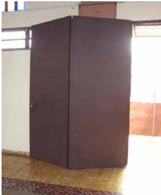
FIG.243 Fotografía de una de las hojas rebatibles de las puertas de los accesos laterales.
