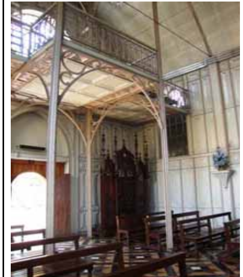
FIG.560 Fotografía de los pilotes, sobre los que descansa el área de coro.
