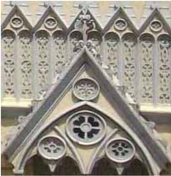
FIG.338 Fotografía del gablete lateral.
