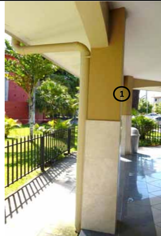
1 Columna de sección regular, a base de concreto armado, repellada, afinada, pintada de color beige y revestidas con baldosas de cerámica hasta una altura de 1.20 m.
