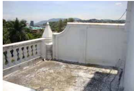
FIG.615 Fotografía de la losa de concreto de la terraza lateral norte del campanario.
