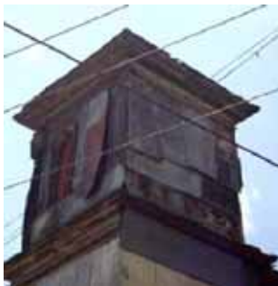
FIG.390 Fotografía de la torre norte, tomada en 2012. Nótese la ausencia de techo en la misma
