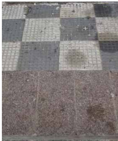
FIG.305 Fotografía del piso del atrio, donde se aprecia el cambio del encementado sisado y las baldosas de cemento texturado.
