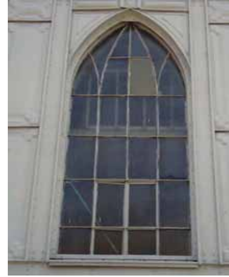
FIG.557 Fotografía de una de las ventanas con arco ojival de la fachada norte.
