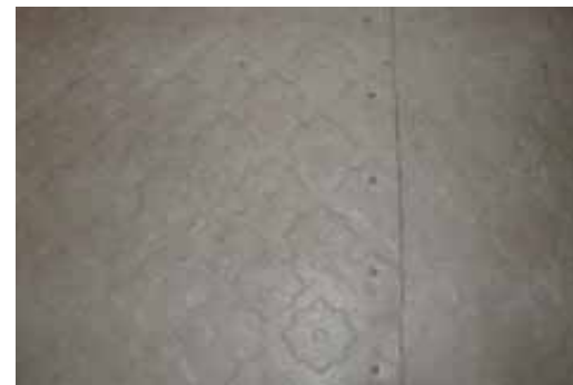
FIG.563 Arriba: Fotografía del cielo falso de la capilla. Abajo: Fotografía que muestra las decoraciones de la lámina del cielo falso.
