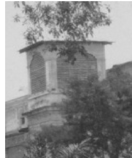
FIG.204 Imagen de la torre de la iglesia parroquial San José, extraída de la FIG.191, en la hoja 4.
