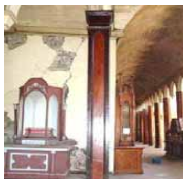
FIG.512 Fotografía de las grietas en una de las naves laterales de la iglesia.
