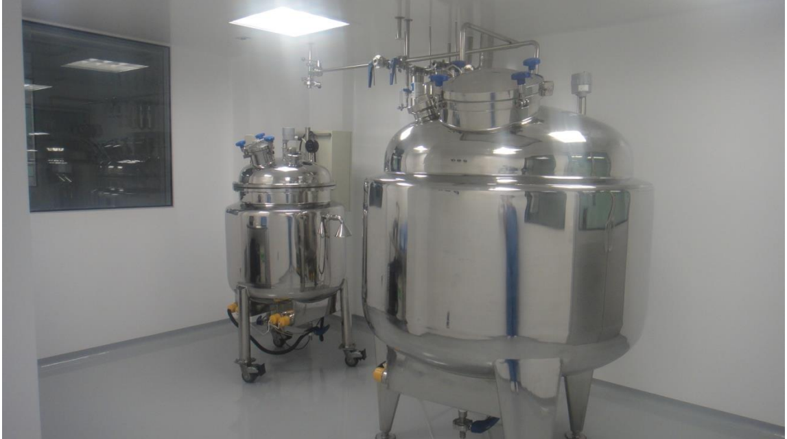
Figura N° 25 Tanques de acero inoxidable de doble chaqueta con capacidad de 250 L y 750 L respectivamente.
