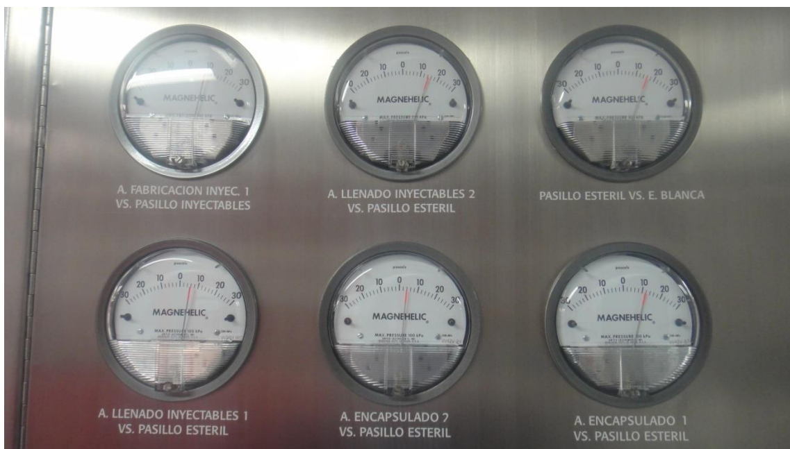
Figura N° 24 Medidores de presión de las diferentes áreas.
