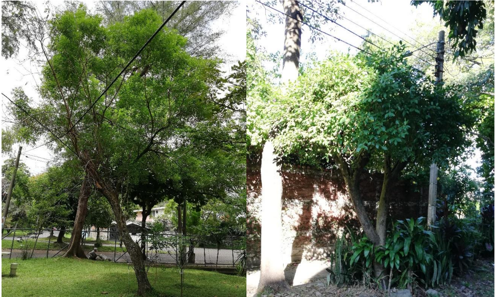
Figura A-10. Árboles en el Parque El Pañuelo que presentan conflicto con el tendido eléctrico.
