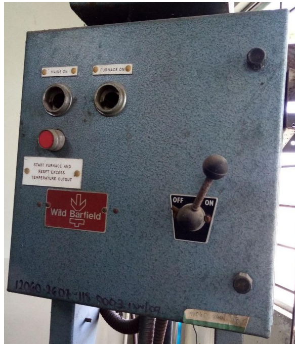
Fig. D.1. Panel de control de temperatura actual.
