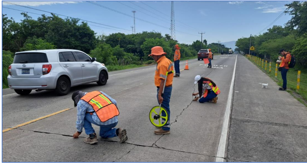
Figura 3.3 Relevamiento de daños.
