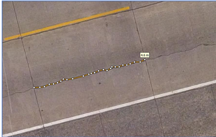
Figura 4.68 Ejemplo de medición del agrietamiento
