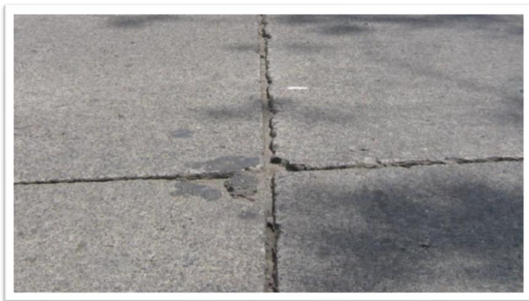
Figura 2.13 Despostillamiento en juntas
