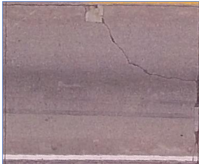
Figura 4.62 Losa con agrietamiento de esquina.
