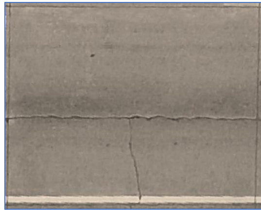
Figura 4.59 Losa con agrietamientos transversal y longitudinal.
