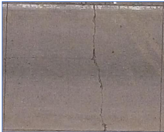
Figura 4.58 Losa con agrietamiento transversal.
