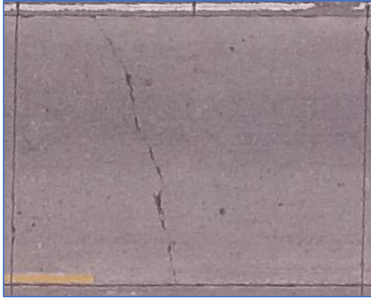
Figura 4.60 Losa con agrietamiento oblicuo.
