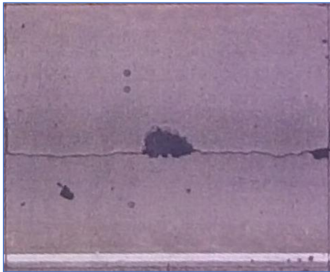
Figura 4.65 Losa con bacheo.
