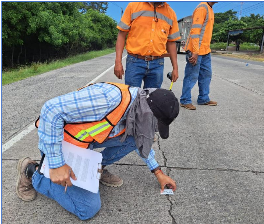
Figura 3.4 Relevamiento de daños.
