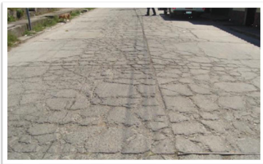
Figura 2.14 Desconche en pavimentos rígidos.
