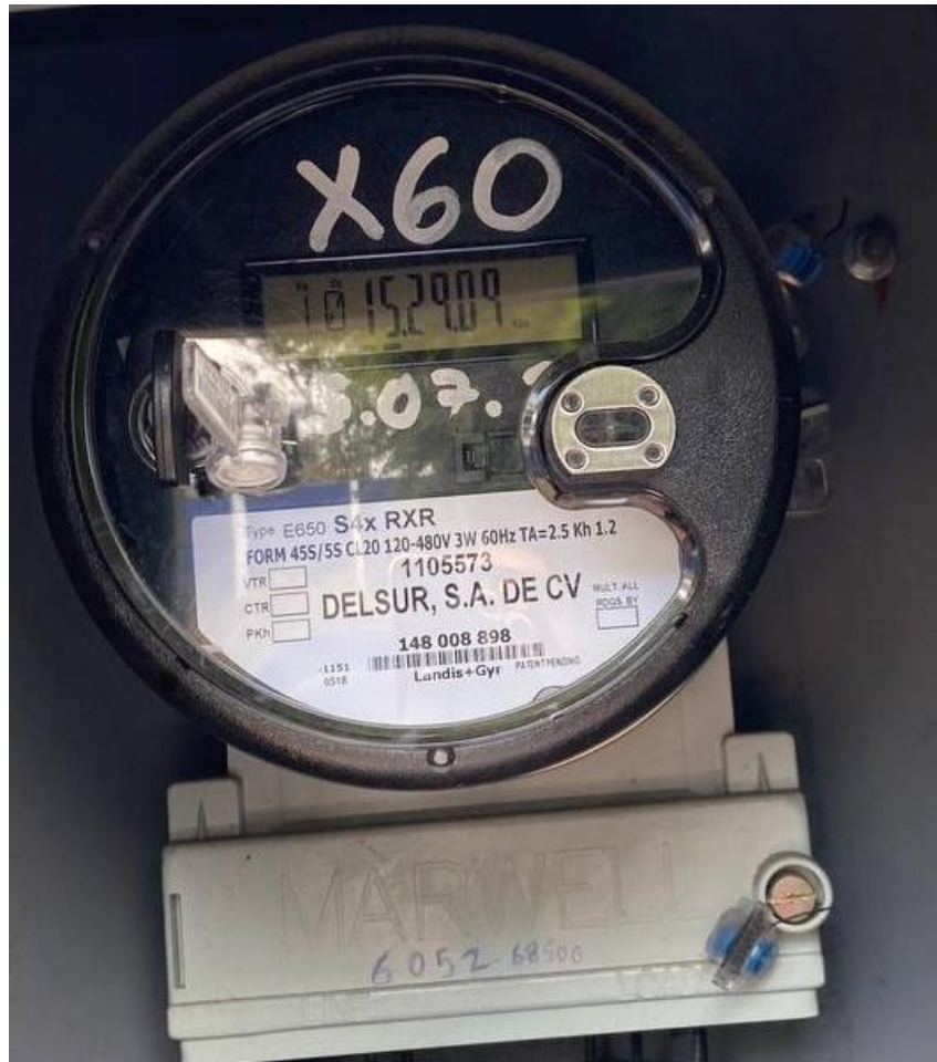
Imagen 2.5: Medidor Landys 45S del CUBO IVU
