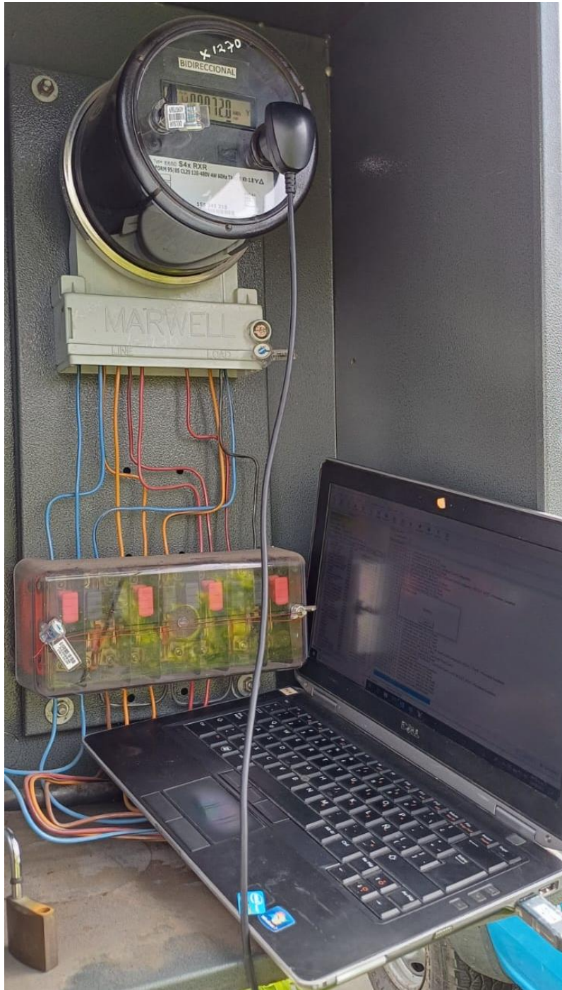
Imagen C.4 Cable óptico USB conectado a medidor
