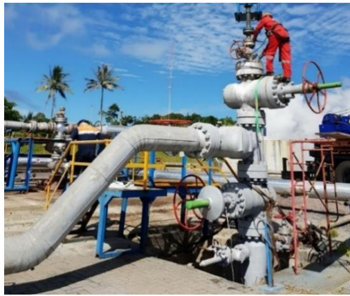
Figura 6: Pozos Geotérmicos. Fuente: Geinor Ingeniería y Servicios, 2022.
