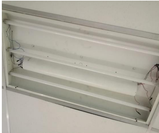
Figura 3.8 Lámpara Fluorescente 3x32 W con las que cuenta el edificio de medicina 1.
