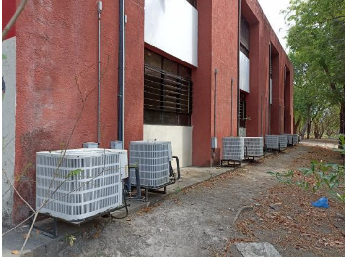
Figura 3.9 Sistemas HVAC en el edificio medicina 1.
