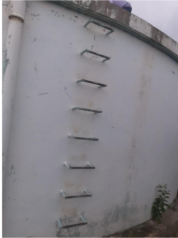
Ilustración 3-10 Lateral del tanque de almacenamiento
