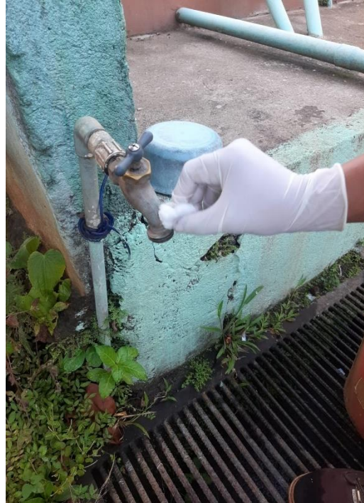
Ilustración A-II Desinfección por flameo en grifo del punto 1
