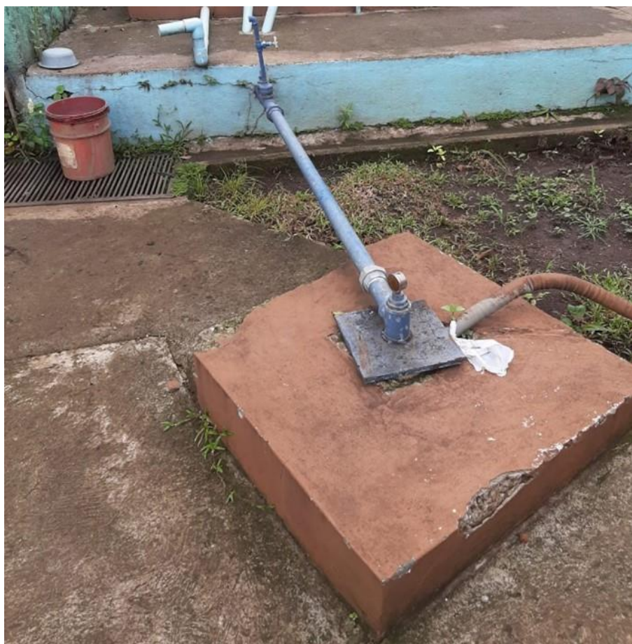
Ilustración 3-4 Salida de bomba en pozo 2
