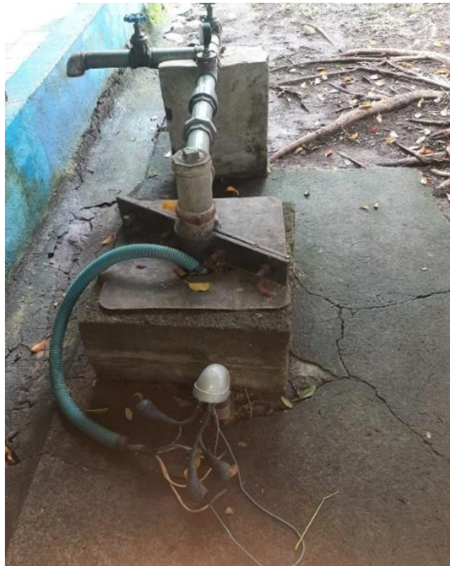
Ilustración 3-3 Salida de bomba del pozo 1
