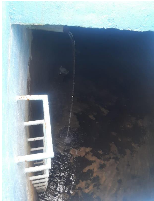
Ilustración 3-11 Interior del tanque de almacenamiento
