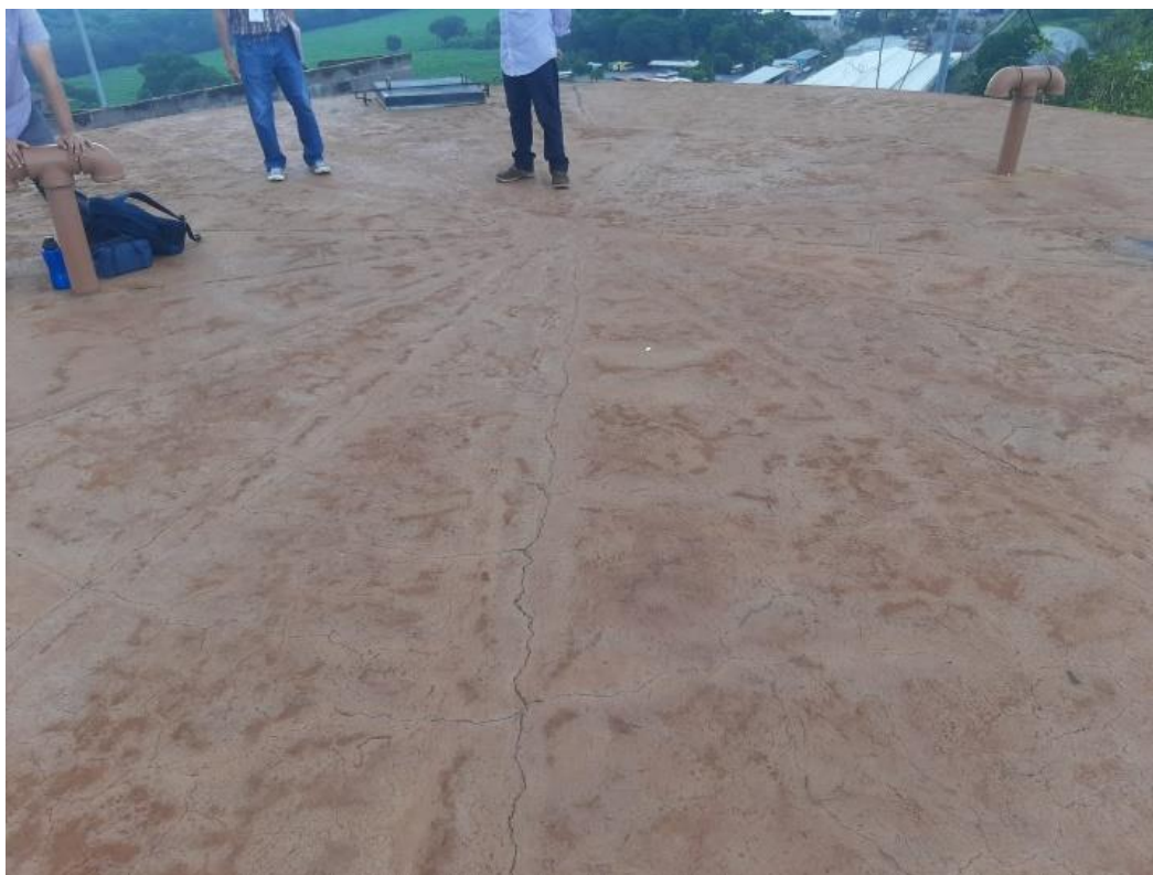
Ilustración 3-9 Parte superior del tanque de almacenamiento
