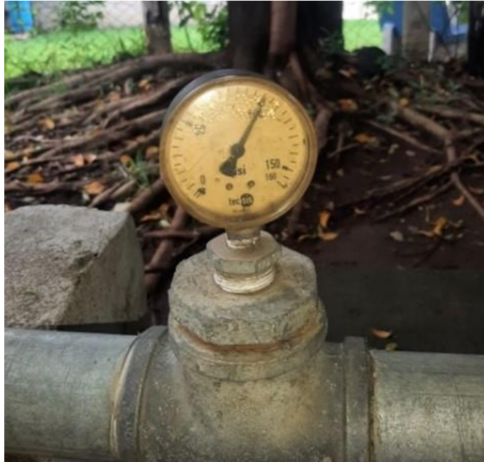
Ilustración 3-2 Manómetro instalado en el pozo 1
