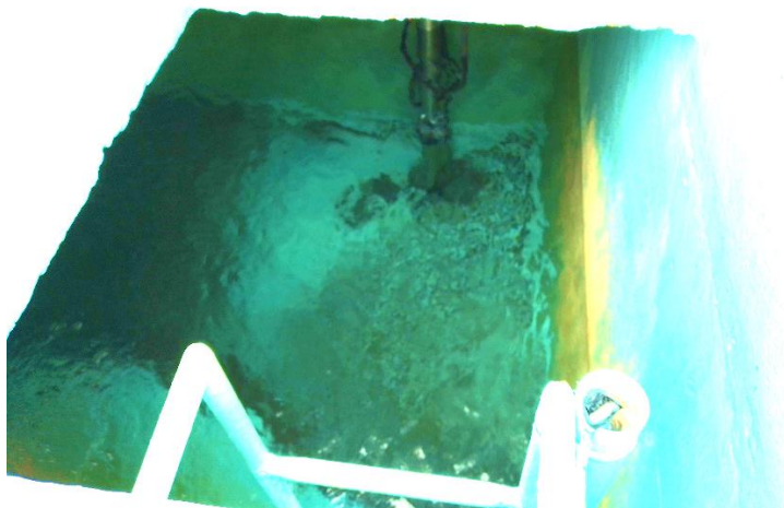
Ilustración 3-8 Vista de bomba 3 en el interior de la cisterna
