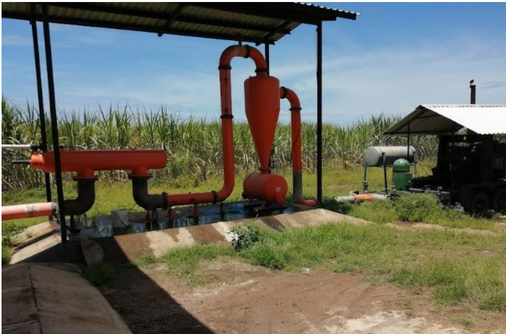
Figura A.12. Hidrociclón en pozo de riego
