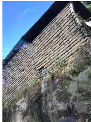
Figura 22. Viviendas vulnerables en Monte San Juan.
