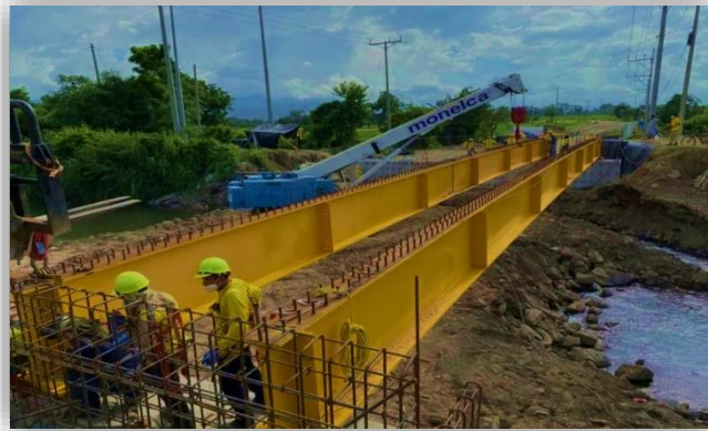
Fig. 1.5 vigas metálicas, san miguel. Fuente: Grupo Monelca
