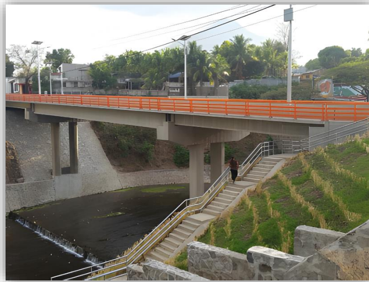
Fig. 1.3 Puente de viga San Vicente, El salvador. Fuente: Civing S.A de C.V
