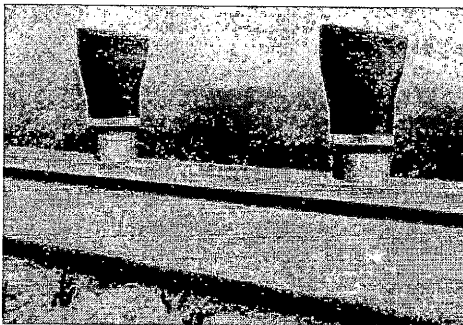
FIGURA 6.7 b): TUBERIA DESPEJADA DEBIDO A LAS VALVULAS PICO DE PATO.
