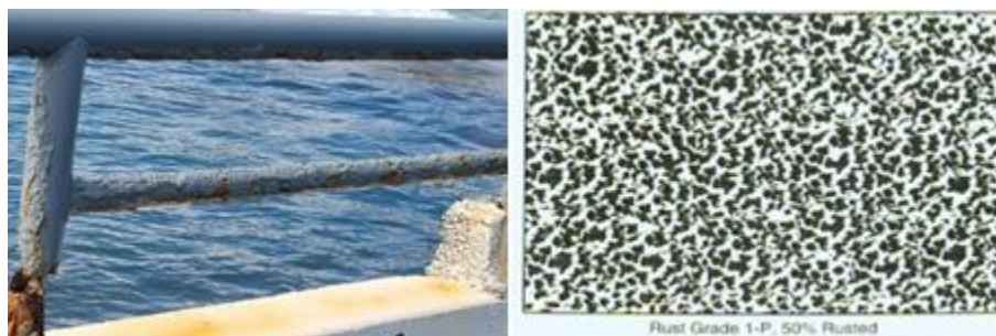
Figura 3.2. Comparación del pasamanos del muelle artesanal del Puerto la Libertad con Corrosión de grado 1-P en blanco y negro, de la normativa SSPC-VIS 2. Visita realizada el 22 de septiembre de 2023.
