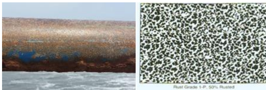
Figura 3.1. Comparación del pasamanos del muelle artesanal del Puerto la Libertad con Corrosión de grado 1-P en blanco y negro, de la normativa SSPC-VIS 2. Visita realizada el 31 de mayo de 2023.
