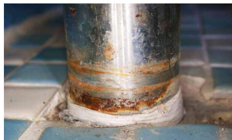
Figura 50. Formación de corrosión en acero inoxidable
