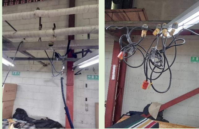
Ilustración 33 Riesgo de contacto eléctrico
