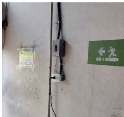
Caja de tomacorriente
