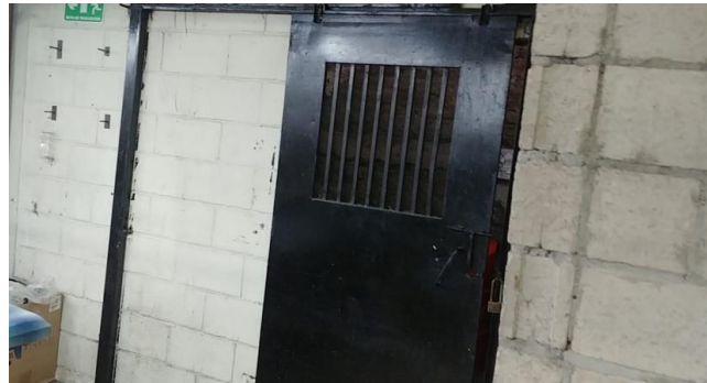
Ilustración 42 Riesgo de atrapamiento
