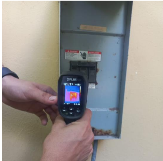
Ilustración 104 Captura termográfica de protección de equipo AA
