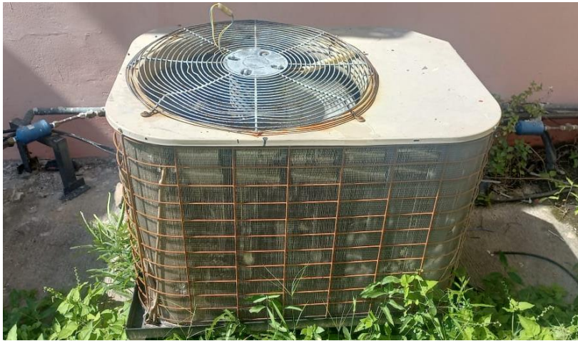
Ilustración 103 Condensador de 5T
