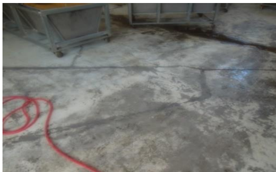
Anexo 5. Pisos agrietados en área de procesamiento de panela granulada.
