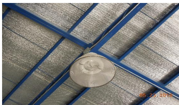
Anexo 10. Lámpara con protección en área de empaqueo del dulce de panela.
