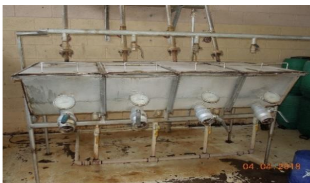
Anexo 12. Tachos para cocido y evaporación de agua de la miel.
