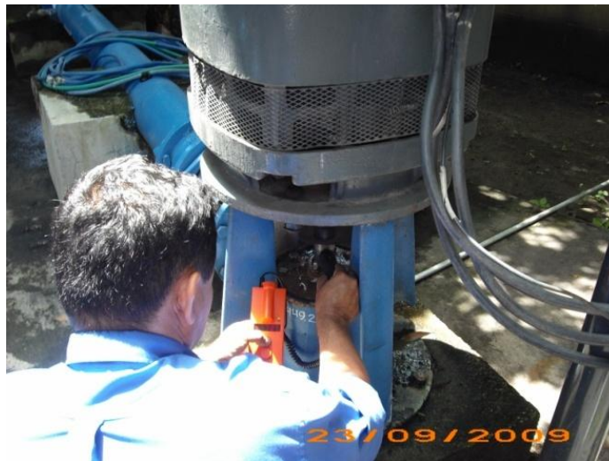
FOTOGRAFÍA QUE MUESTRA LA MEDICIÓN DE LA VELOCIDAD DE OPERACIÓN DE UN MOTOR DE INDUCCIÓN EN UNA BOMBA DE AGUA.
