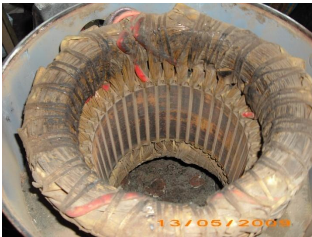
Bobinado que sufrió exceso de temperatura
