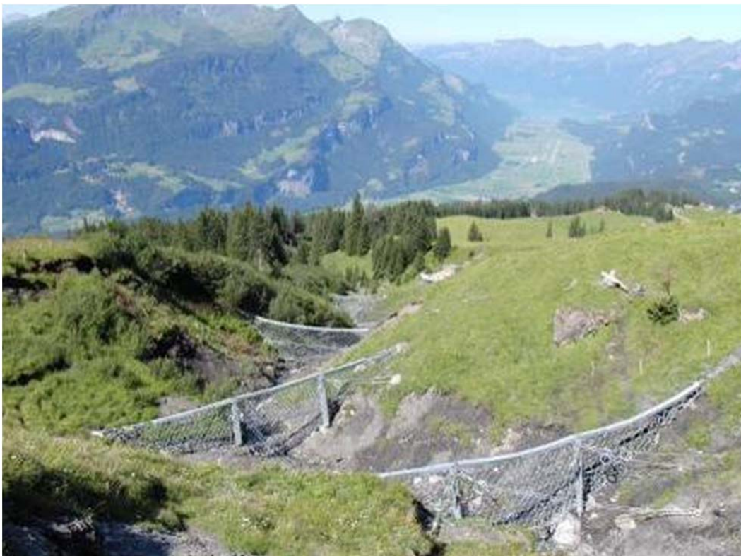
Meiringen-Hasliberg / Suiza (2008): 13 barreras tipo UX/VX instaladas en concepto multi-nivel
