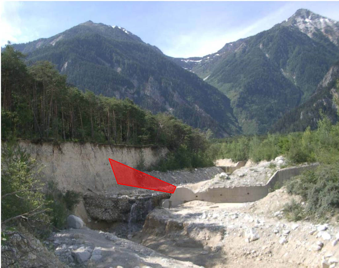
Illgraben, Schwelle 25 / Suiza (2007): Otro ejemplo para sustitución exitosa de una estructura de concreto como primer paso para poder corregir la dirección del caudal hacía la derecha y proteger la ladera izquierda de erosión. Con esta finalidad se planifica una segunda barrera (con forma triangular), colocada de manera sesgada y arriba de la primera barrera.
