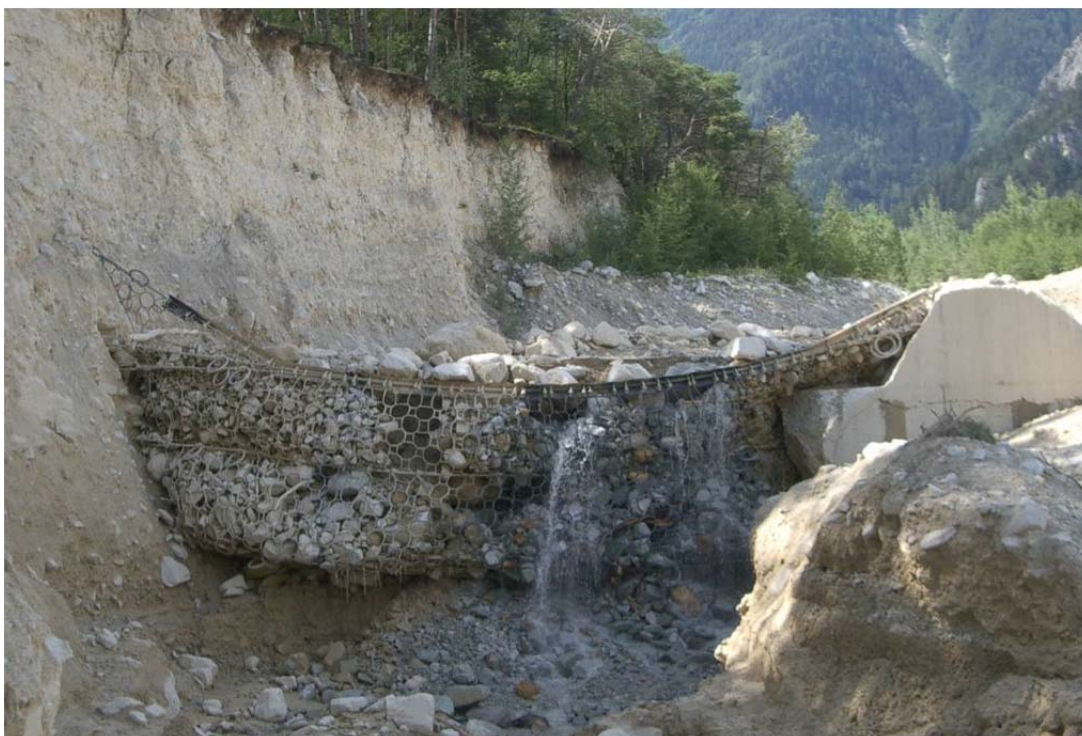
Illgraben, Schwelle 25 / Suiza (2007): Vista de la barrera ya instalada y después de 2 impactos diferentes
