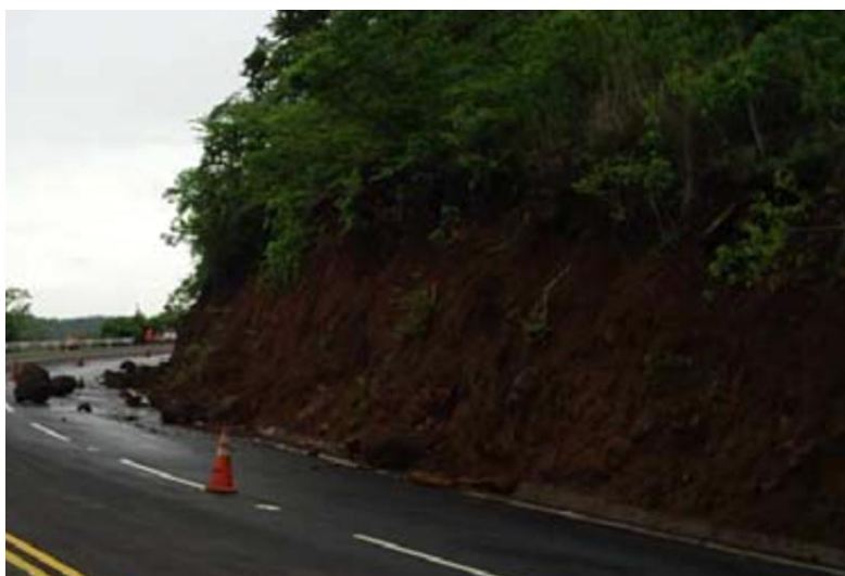
Figura 5 Deslizamiento de tierra en carretera Panamericana, cerca de Quebrada Seca, debido a Depresión Tropical Adrián.
