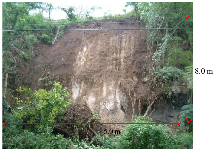
Figura 3 Deslizamiento de tierra en campo geotérmico de Berlín, debido a depresión tropical Adrián.
