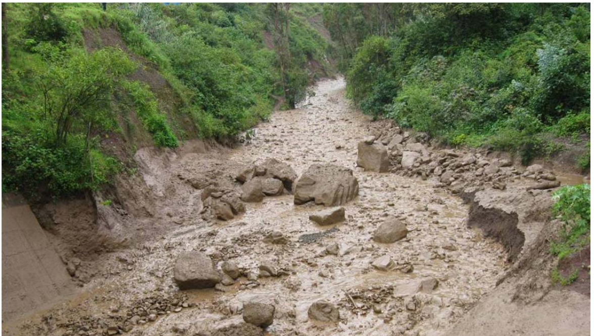
Vista hacia aguas arriba con el deposito de aprox. 15'000 a 18'000 m 3 de flujo de detritos (huayco) que fue retenido exitosamente por la misma barrera UX
