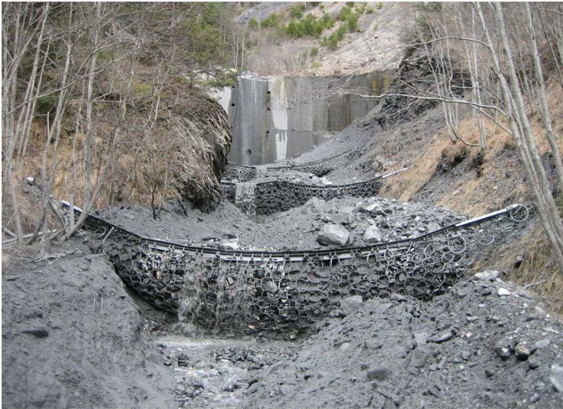
Merdenson / Suiza (2007): Ejemplo exitosa para la protección de un puente aprox. 400 m más abajo en la cuenca y de la sustitución económica de estructuras de concreto ("checkdams"), vista hacía aguas arriba
