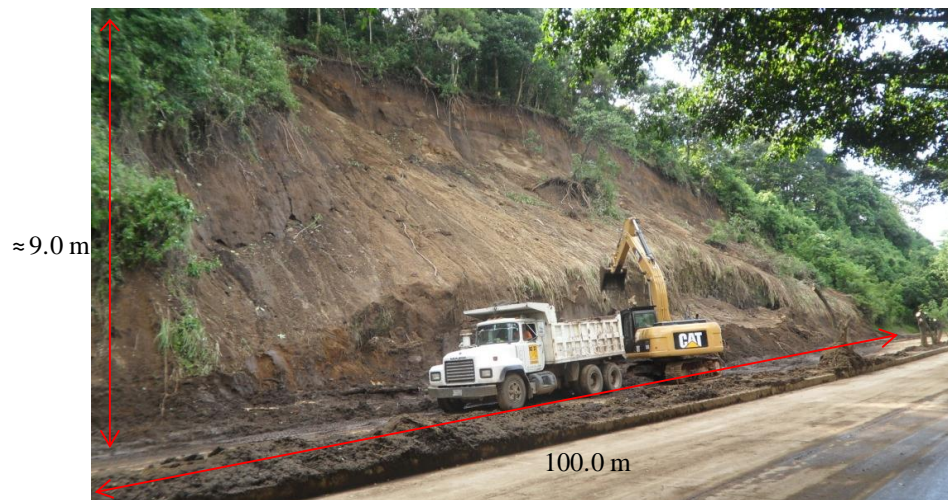
Figura 18 Derrumbe de 1,200 m 3 , 9.0 m de altura y 100 m de longitud sobre el bulevar Sur, municipio Santa Tecla, departamento La Libertad, debido a Depresión Tropical 12 E.
