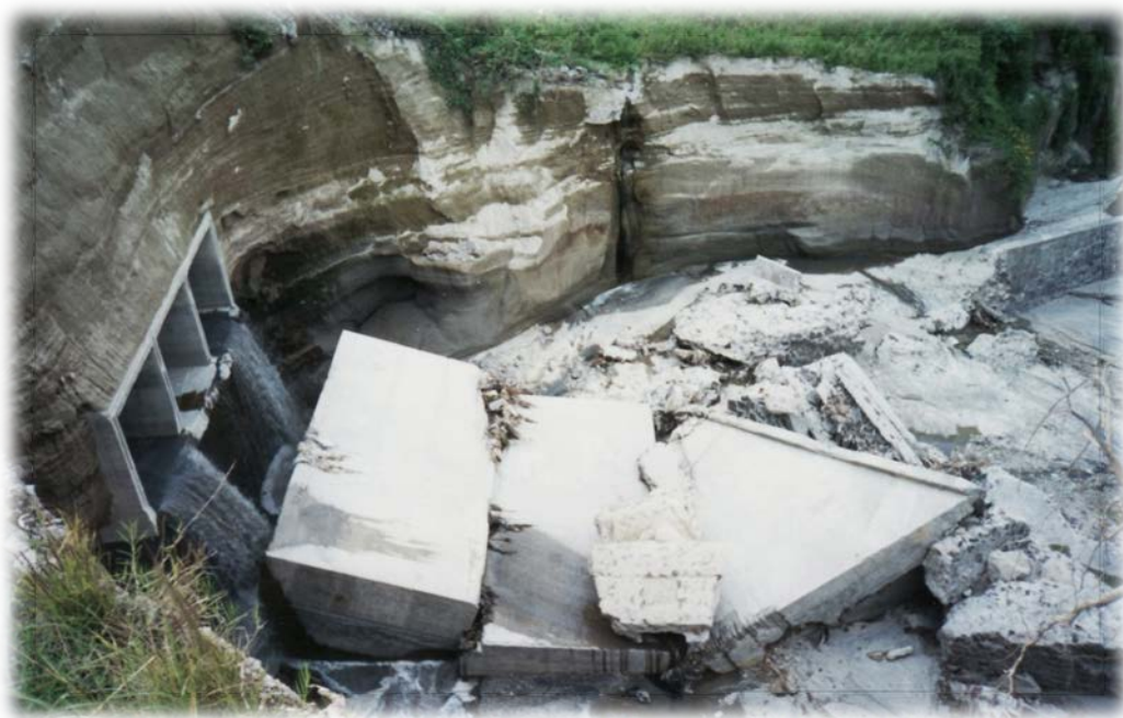
FOTOGRAFÍA N°3.8: Caja Triple sobre río Las Cañas, km 4+350 Autopista San Salvador – San Miguel, vista de la salida del río, estructura colapsada.
