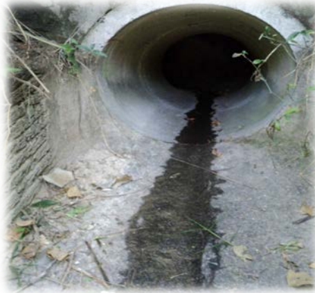
Tubería de ALL dañada
