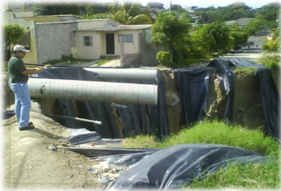
FOTOGRAFÍA N°3.4: Tuberías colapsadas en Cárcava de la Colonia Santa Lucía en Ilopango. FUENTE: Ministerio de Obras Públicas.
