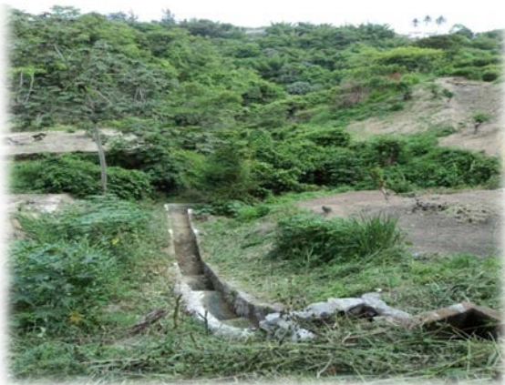
Derramadero del colector colapsado
