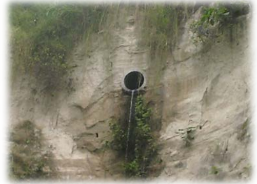
Tubería de 36 pulgadas, descarga del colector se observa que no tiene protección
