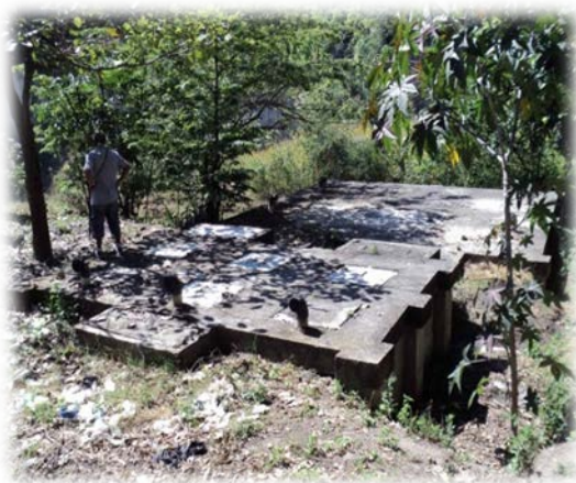
Planta de Tratamiento de aguas negras en peligro de ser arrasada por la Cárcava
