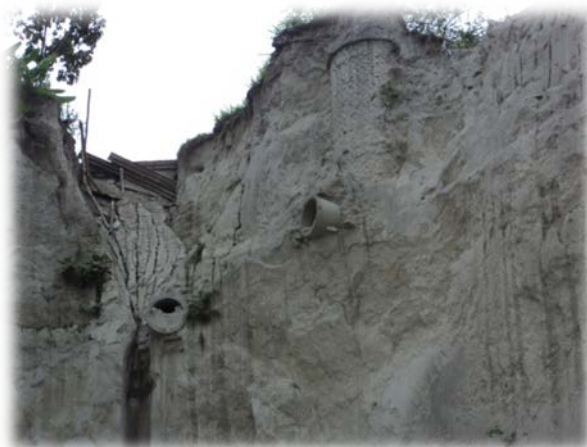
Pozo y tubería colapsados
