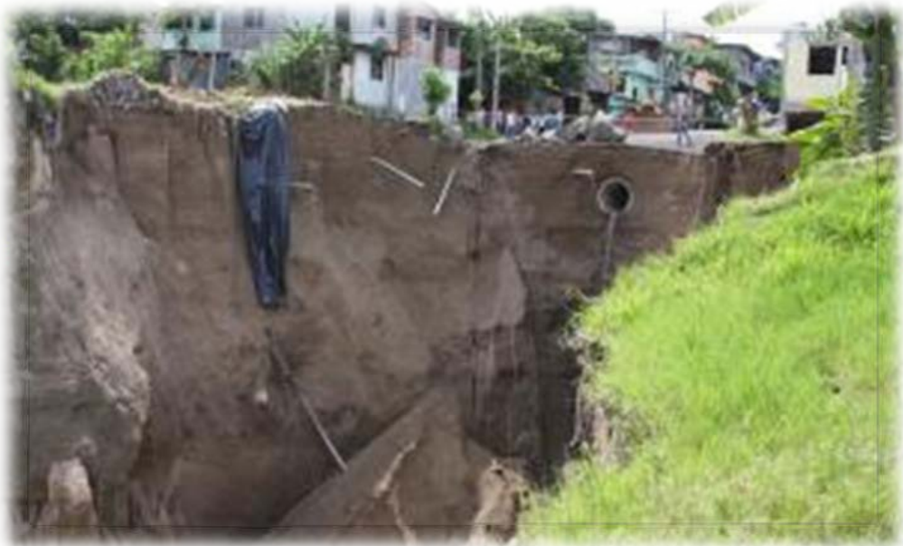
FOTOGRAFÍA N°3.6: Cárcava Las Cañas en Ilopango.
