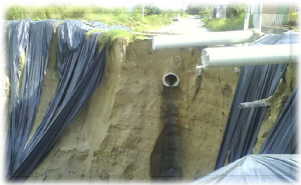
FOTOGRAFÍA N°3.5: Tubería de aguas lluvias Colapsada en Cárcava de la Colonia Santa Lucía en Ilopango.
