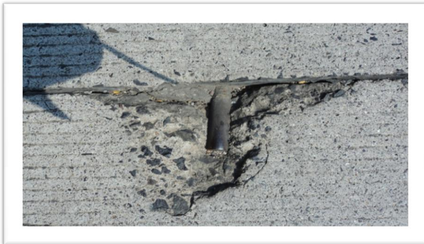
FIGURA 4.6: Despostillamiento visto en levantamiento de deterioros.
