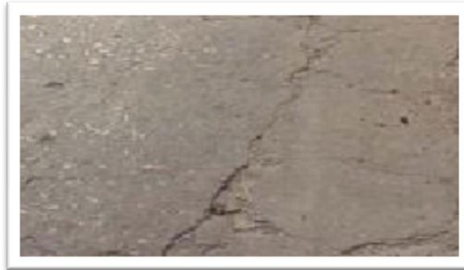
Figura 2.6.1 –B Desconchamiento, mapa de grietas y craqueado de severidad media.
