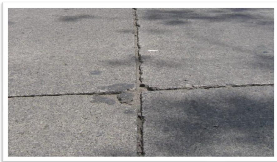
Figura 2.5.2. Despostillamiento en Juntas
