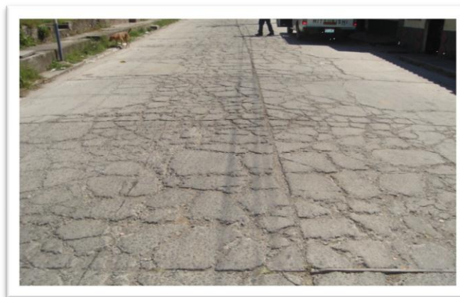
Figura 2.6.1- C Desconchamiento, mapa de grietas y craqueado de severidad alta.
