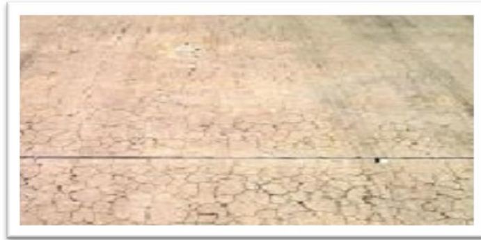
Figura 2.6.1 – A Desconchamiento, mapa de grietas y craqueado de severidad baja.
