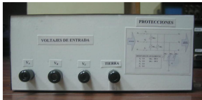
Figura A.2.15 Vista frontal de las protecciones
