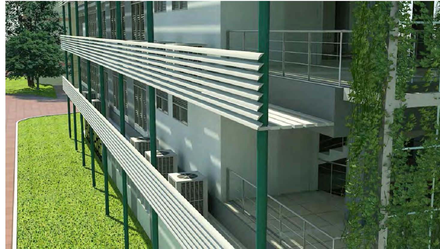
DETALLE DE EQUIPOS CLIMATIZACION EN FACHADA NORTE
