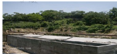
Biodigestor Granja porcina San Jose. Sensuntepeque.
