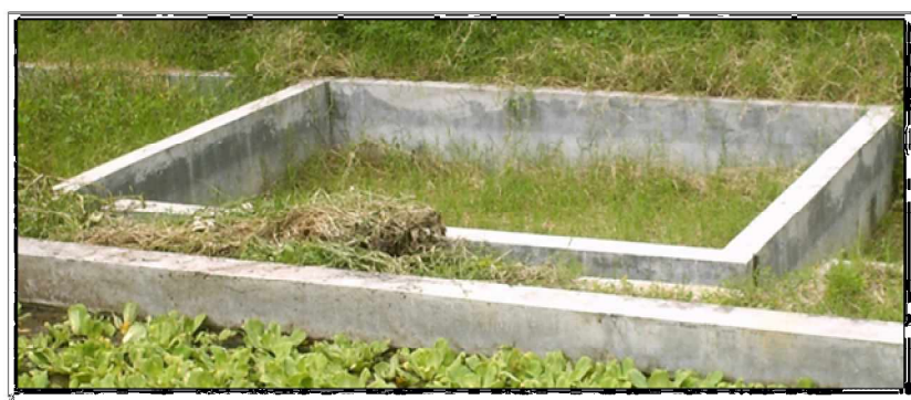
FIG 2.16 Foto de pila para secado de lodos
