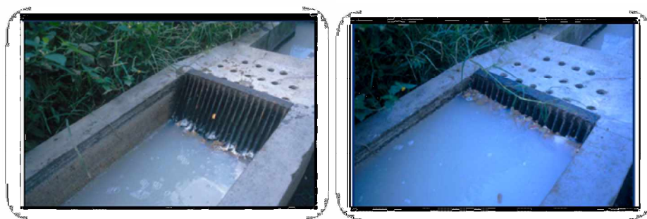
FIG 9.1 Canal de rejillas con obstrucción
