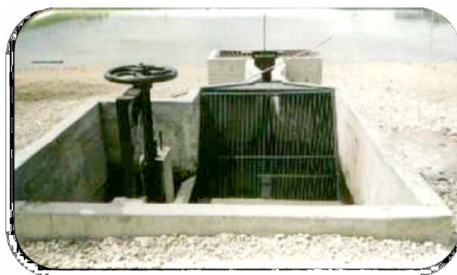
FIG 2.10 Foto de uso de rejillas.
