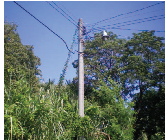
(Fig. 12) Poste de Tendido Eléctrico.
