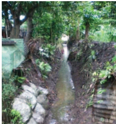
(Fig. 11). Canaleta de aguas lluvias.
