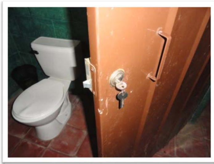
Foto 32: CDIC Piedras Pachas, chapa de sanitario
