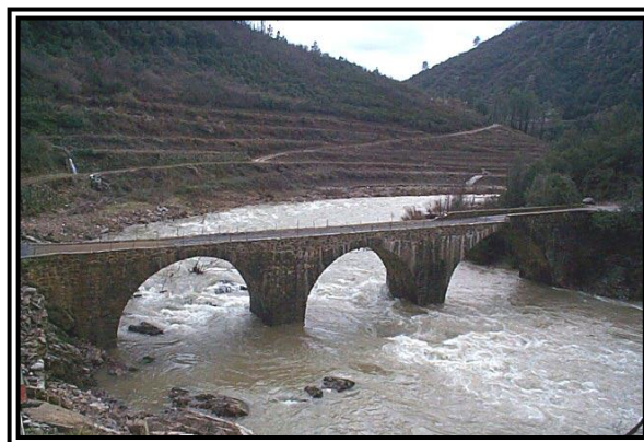
FIG . 2. 90 Ejemplo de reducción del área hidráulica del cauce 113 .
