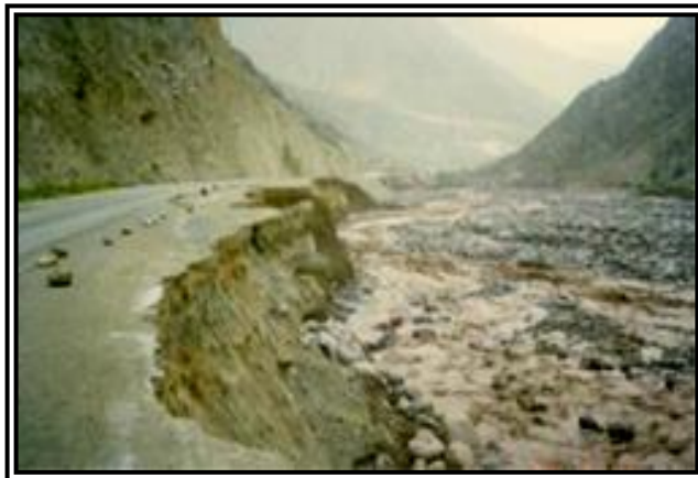
FIG . 2. 91 Ejem plo de socavación en la curva del río 114 .
