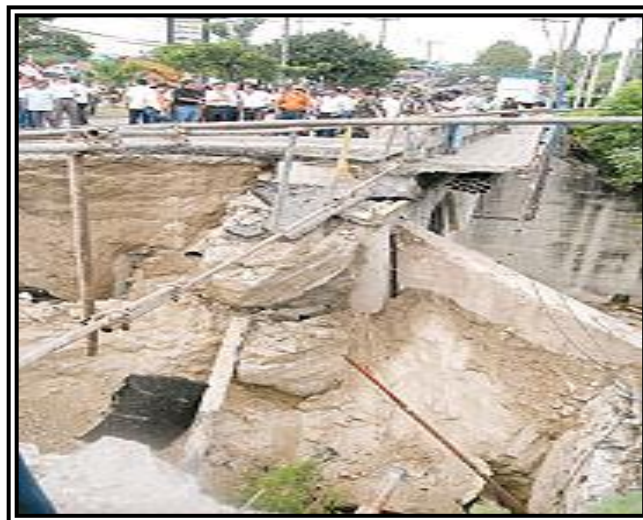
FIG. 1. 2 Colapso del puente Eureka sobre el boulevard del ejército, San Salvador, El Salvador. 3
