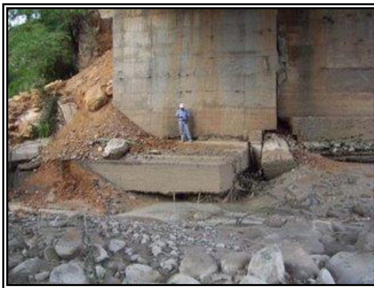
FIG. 2.95 Ejemplo de socavación local en estribos.
