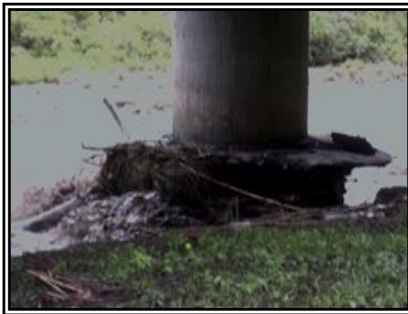
FIG. 2.94 Ejemplo de socavación local en pilas 116 .
