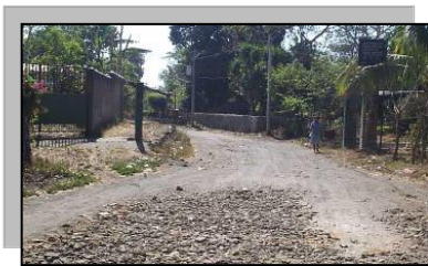
Imagen No. 10 Estado actual de la Calle Principal
