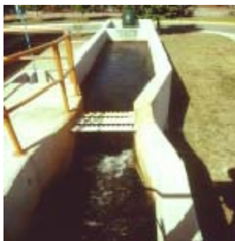
Figura 7.3 Medidor de caudal Parshall
