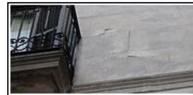
REPELLOS Y ESTUCOS QUE SE DESPRENDEN * IMAGEN 64
