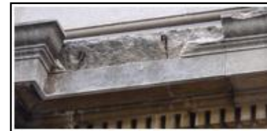
CORNISAS EN MAL ESTADO
