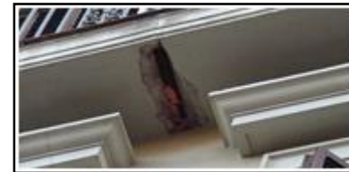
BALCONES CON VIGAS OXIDADAS
