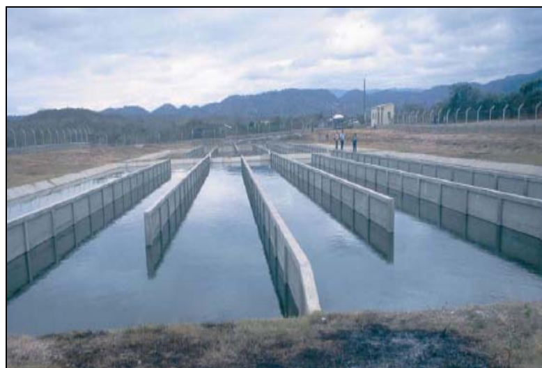
Figuras 5.3.1.4.a: Ejemplos de lagunas de maduración que están canalizadas con mamparas. En la foto de arriba la relación largo/ancho aproxima 20/1, y en la foto abajo 50/1. En la foto abajo, las mamparas están demasiado arriba del nivel del agua y prohíben la insolación solar por la sombra que forman; deben estar más por abajo como en la foto arriba. (Foto arriba: Trinidad, Honduras; abajo: Morocelí, Honduras)
