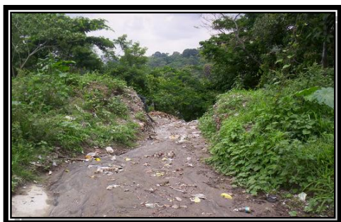
Fotografía No 55 Muestra la falta de un adecuado drenaje en el terreno
