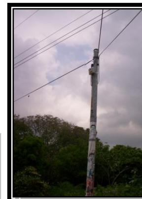
Fotografía No 51 Alumbrado publico, disgregado en el área de análisis
