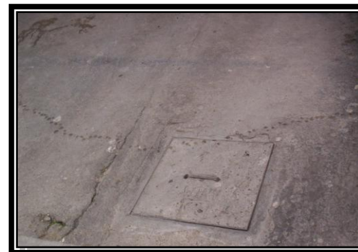
Fotografía No 44 Acometida Domiciliar (ANDA)
