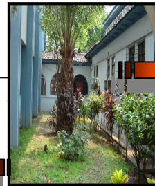
VISTA LATERAL DE EDIFICIO "H" NOTA: 2° Y 3° NIVEL DESHABILITADO POR DAÑOS EN LA ESTRUCTURA
