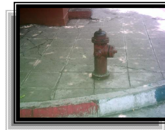
Fotografía No. 71. Dos de los 17 hidrantes que existen en la ciudad, se encuentran en la zona de estudio.
