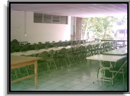
Fotografía No. 9 Área de mesas de la cafetería, esta funciona de manera provisional y eventual, el centro carece de un espacio adecuado para esta función.
