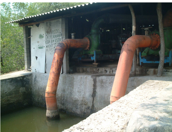
Estación de Bombeo
