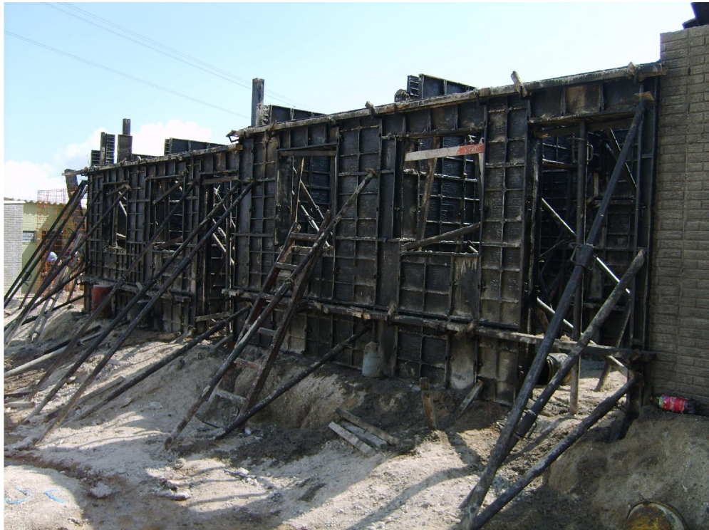
Anexo No.19. Moldeado de las paredes en el sistema de paredes de concreto moldeado y vaciado in situ.
