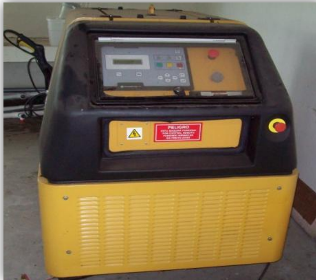
Ilustración 20: Planta eléctrica del laboratorio de reproducción de alevines TGM de la EASCP.
