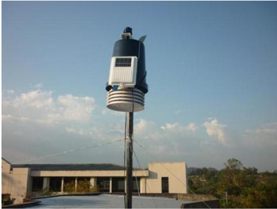
Figura 79. Instalación de los Sensores
