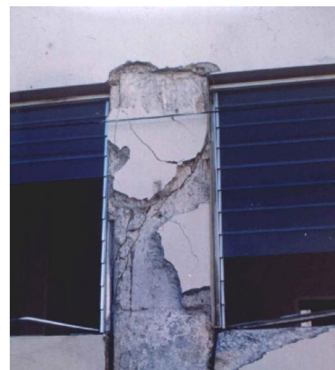
Fig. 1.3. Daños por efecto de columna corta
