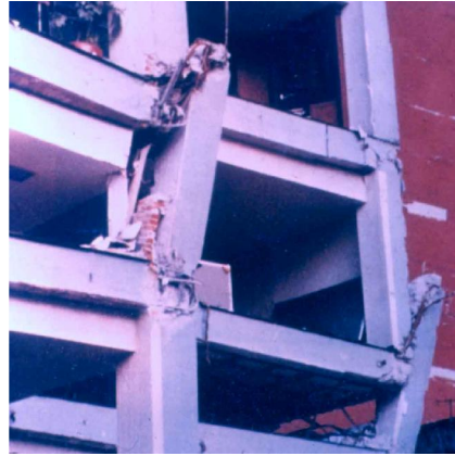
Fig. 1.8. Daño en los nudos de la estructura.
