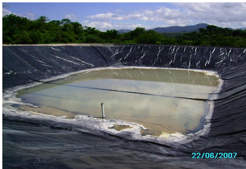
Figura. 3.3.1.1. Reservorio construido en Cutuco, como sedimentador principal del sistema de agua potable abastecido de la quebrada Las Marías.
