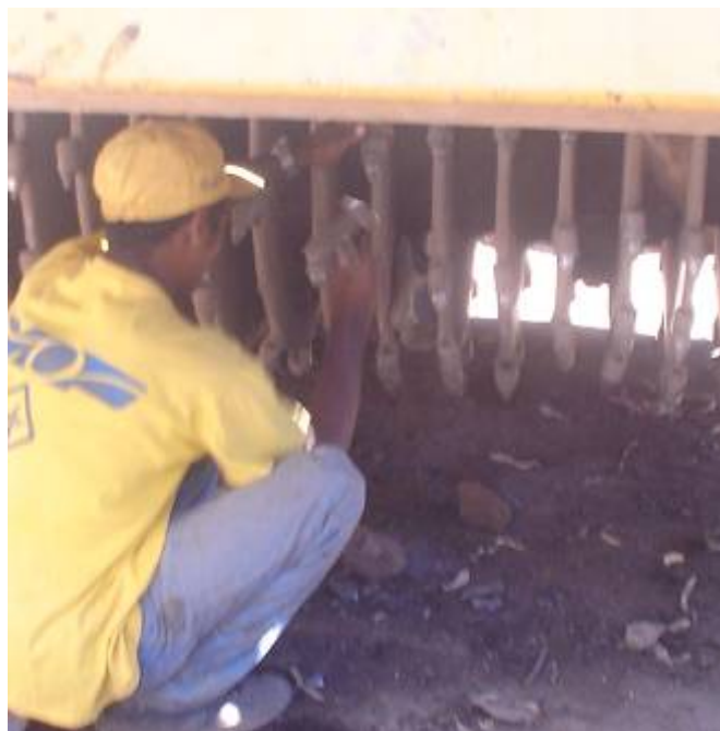
Fotografía 12: Un empleado realizando el mantenimiento y reparación de los discos de la máquina mezcladora. Mediante el retiro de rocas incrustadas entre los discos de corte y la colocación de algunos dientes de los mismos.
