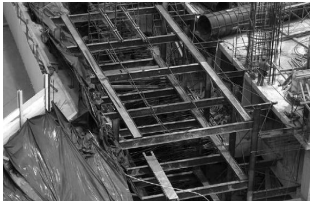
Figura 2.28. Apuntalamiento Gigante de muros perimetrales en Torre Futura. Fuente: Revista ASIA, 2009, Edición 164, El Salvador.
