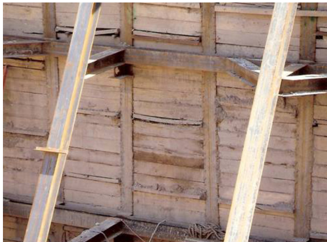
Figura 5.34. Arreglo de sistema de apuntalamiento inclinado. Fuente: R.C.J. Construction Services, Brooklyn, New York. Ankara, Turkey
