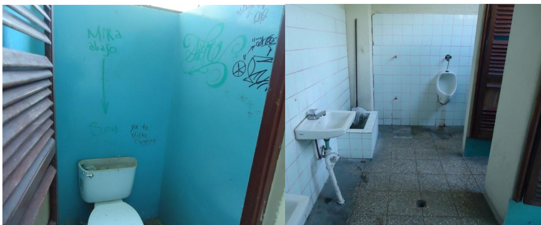
Estado actual de los baños de hombres de la primera planta.
