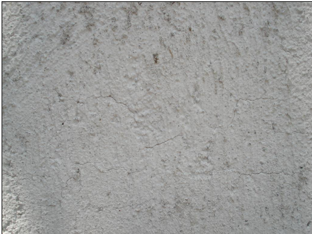
Figura 5.7 Repello con mortero elaborado con cemento Pórtland mezclado con el contenido medio de cal a los 7 días de haber sido colocado.
