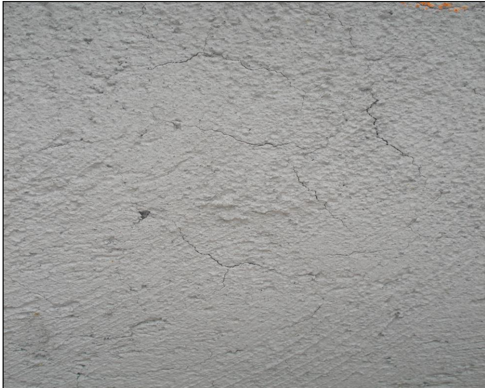
Figura 5.8 Repello con mortero elaborado con cemento Pórtland mezclado con el contenido medio de cal a los 14 días de haber sido colocado.
