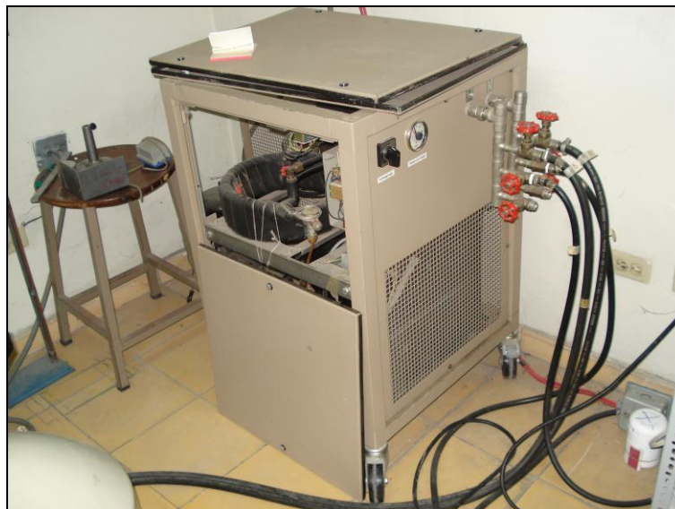
Figura 3.39 Equipo encargado de suministrar agua al sistema de enfriamiento del PW1730/00
