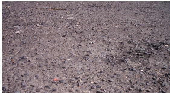
Fotografía 2.15 Exposición de agregados. 43 Av. sur entre prolongación Calle Arce y Juan Pablo segundo, San Salvador
