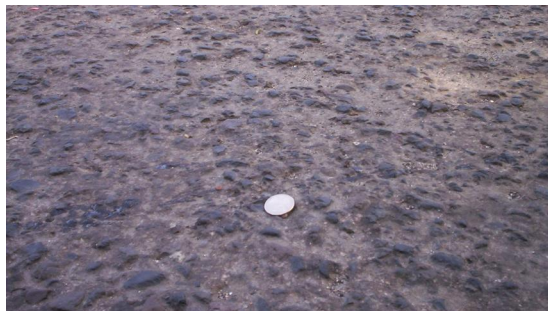
Fotografía 2.14 Desgaste de agregados. Intersección prolongación Calle Arce 43 Av., San Salvador
