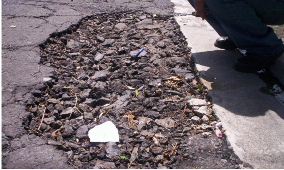
Fotografía 2.12 Pérdida de base. Prolongación calle Arce entre 41-43 Av. Norte
