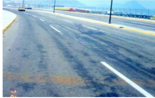
Fotografía 2.13 Exudación de Asfalto
