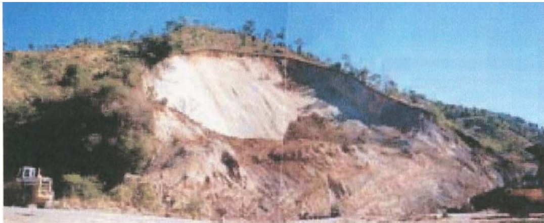
Fotografía 3.4 Deslizamiento ocurrido en Curva La Leona, Carretera CA-2 a San Vicente
