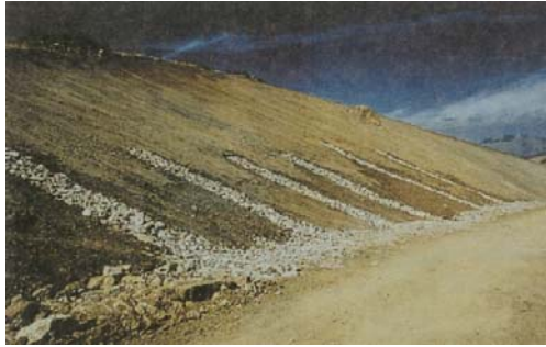
Fotografía 4. 21. Ejemplo de un sistema de drenes transversales, tomado del libro "Ingeniería Geológica".
