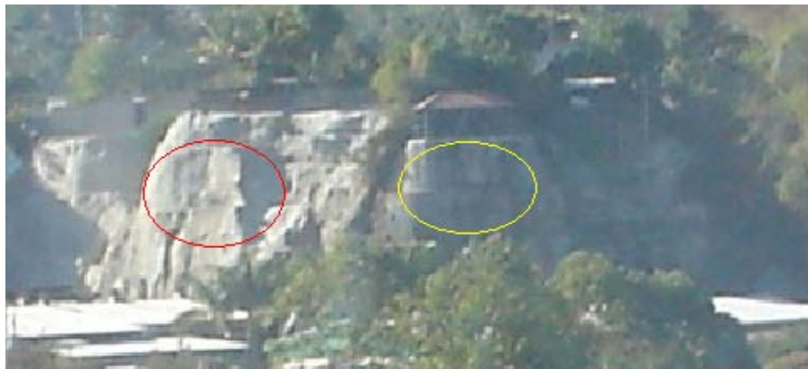
Fotografía 4.46. El recubrimiento de taludes con mortero para evitar la erosión es utilizado con éxito inclusive en taludes de 90° como se observa en la parte con el círculo amarillo. En muchos casos ni siquiera se realiza la conformación de los taludes (zona con el círculo rojo).
