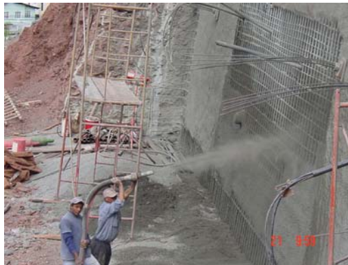
Fotografía 4.75. Colocación de concreto lanzado para la conformación de una pantalla en un talud.
