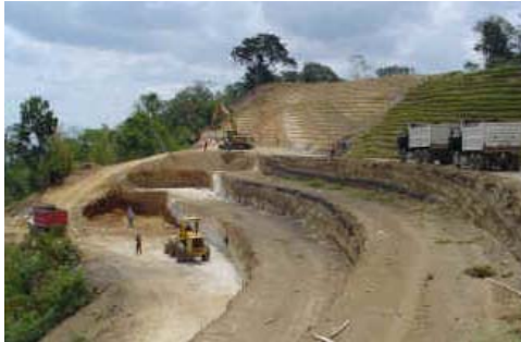
Fotografía 4. 4: Conformación de futuras terrazas a compactar en talud, Col. Las Colinas, La Libertad.
