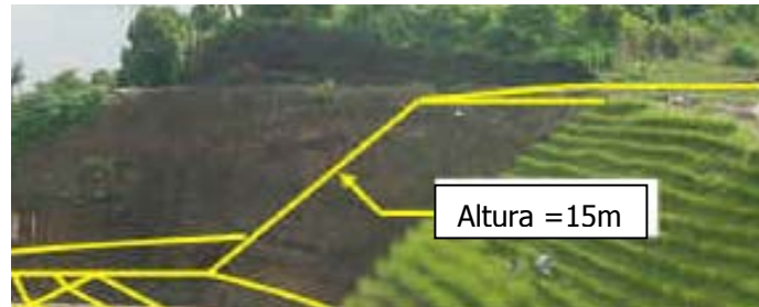
Fotografía 4. 1. Proyección futura de talud por relleno, Col Las Colinas, La Libertad.
