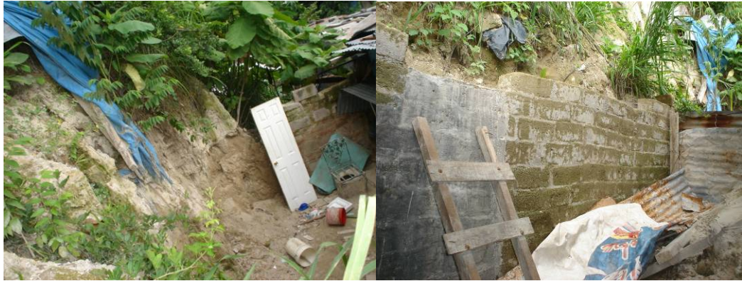
a) b) Fotografía 5.5. Viviendas ubicadas en el pie del talud en la comunidad La Providencia: a) Algunas personas intentan expandir el área de su terreno haciendo cortes al pie del talud, b) la preocupación de las personas les lleva a construir muros o barreras que retengan un poco el material que se desliza.
