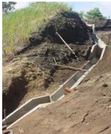
Fotografía 4. 16: Construcción de cuneta rectangular de concreto "in situ", Col. Las Colinas, La Libertad.
