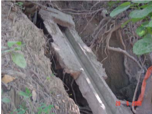
Fotografía 4. 10: Erosión de talud bajo una medida de drenaje superficial (canal de concreto) Calle El Carmen, Col. Escalón.
