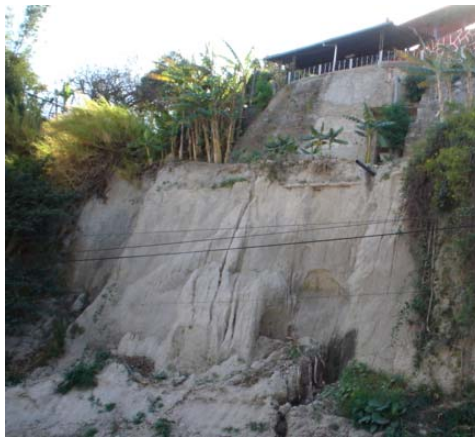
Fotografía 4.42. La parte superior de este talud fue protegida con un revestimiento de mortero; sin embargo, la parte inferior al haber quedado expuesta presenta un deterioro notorio que posiblemente hará colapsar la parte superior.
