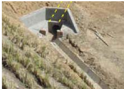
Fotografía 4. 18: Caja generando cambio de dirección de flujo de agua en talud, Col. Las Colinas, La Libertad.
