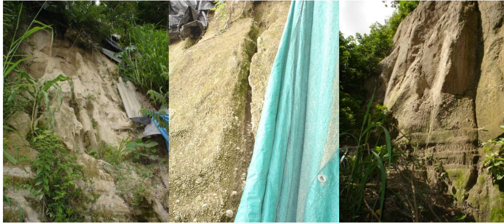
Fotografía 5.4. Fallas comunes en taludes de tierra blanca observadas en Comunidad La Providencia: a) y b) Cárcavas o zanjas provocadas por la erosión, c) Exfoliación o caída por capas del material debido al intemperismo.
