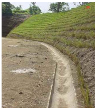
Fotografía 4. 17: Contracuneta en base de talud, Col. Las Colinas, La Libertad.
