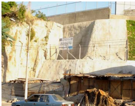
Fotografía 4. 7: Descabezamiento de Talud en Av. Juan Pablo II
