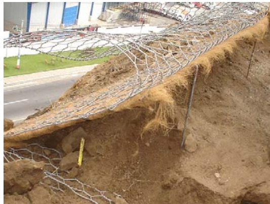
Fotografía 4.79. Colocación de los geotextiles que conforman el sistema Terra Mesh sobre la superficie de un talud.
