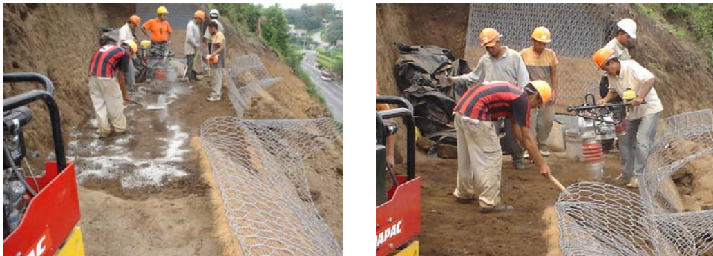
Fotografías 4.81 y 4.82. Proceso de compactación de las capas de suelo para el sistema Terra Mesh.
